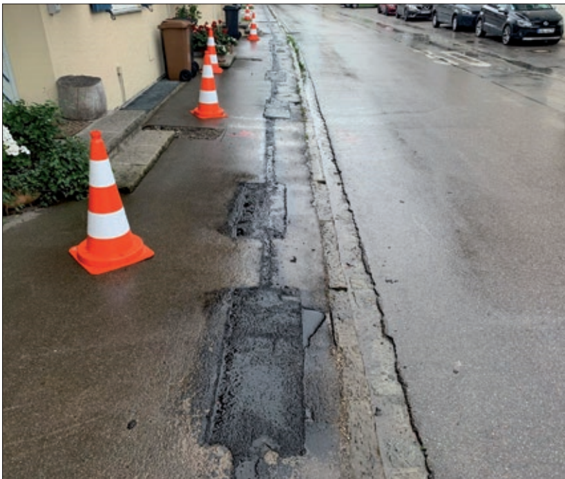
Bild 3. Negativ-Beispiel Trenching-Baumaßnahme: Diese Ausführung sollte man weder der Straße noch seinem Auge antun
